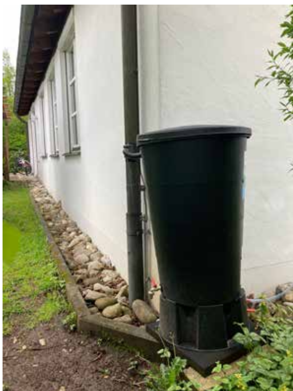
Regentonne im Gemeindezentrum Sonthofen: automatisches Sammeln von Regenwasser mit Wasserstopp
